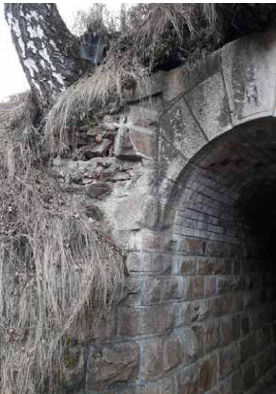
Водопропускная труба между Лазурным и Козулькой
